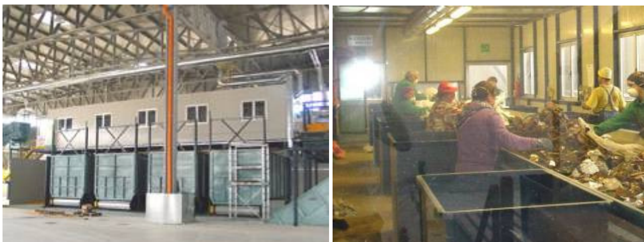
Fig. 9 – La cabina di selezione del rifiuto: l'esterno ed il particolare dell'interno.
